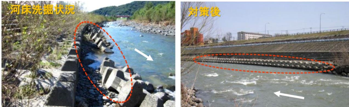
河床洗掘と既設護岸の根継ぎ 第 11 回石狩川流域委員会資料(平成 31(2019)年 1 月 9 日)
