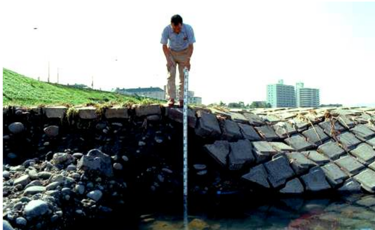
低水護岸被災状況(豊平川・南 19 条大橋上流右岸)
