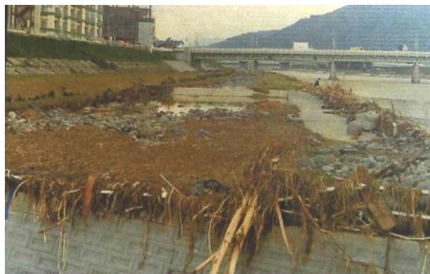
6号床止右岸下流高水敷の洗掘
