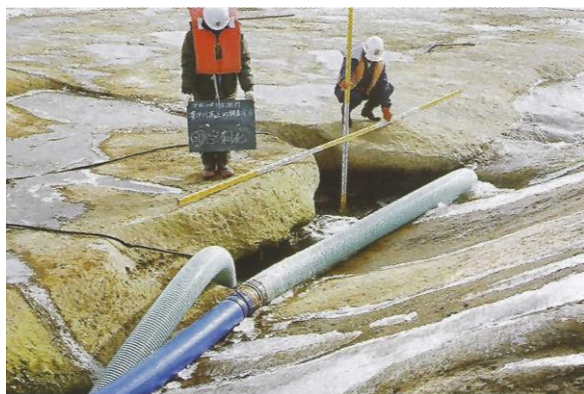
7号床止本体直下の空洞化
