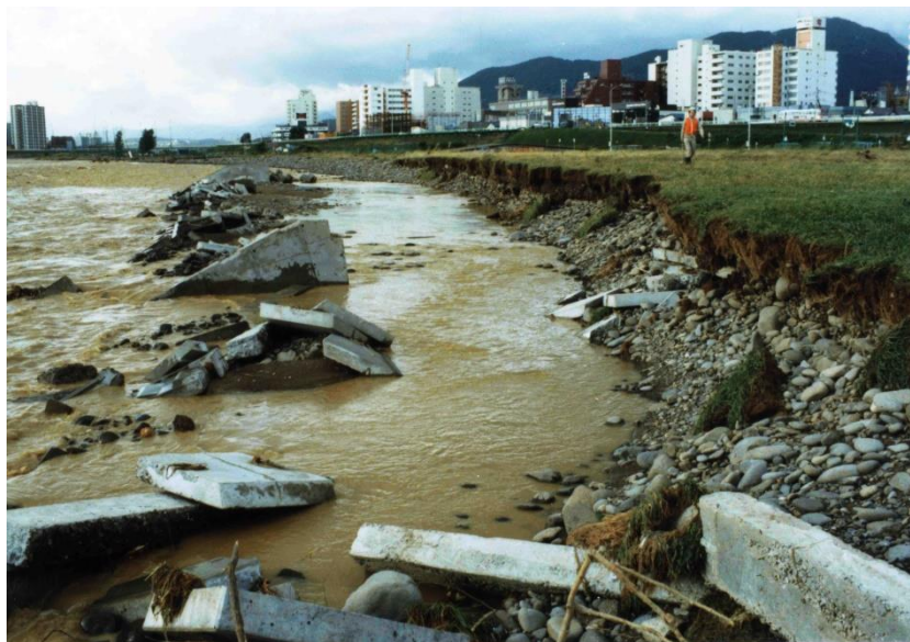
低水護岸被災状況(豊平川・南大橋上流左岸)
