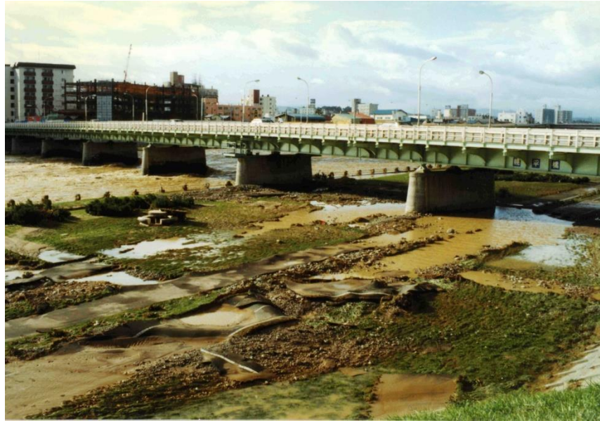
高水敷被災状況(豊平川・幌平橋下流左岸)
